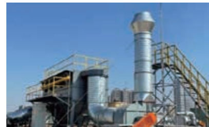
我們位於中國沙井的工廠的空氣排放處理設施
