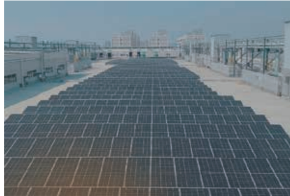
2022年我們在江門工廠安裝的太陽能電池板
